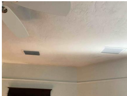
Upstairs SE bedroom AC vent
